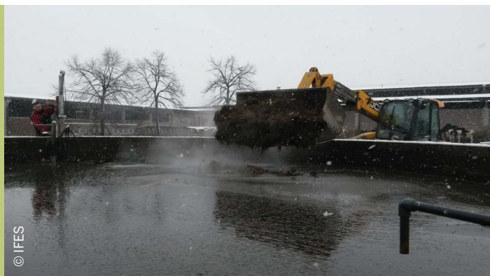
Imagen 22. Carga de biomasa sólida en tanque de premezcla con pala frontal
