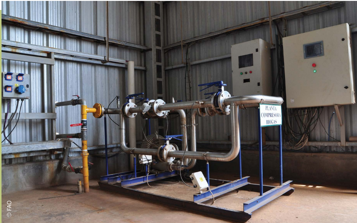
Imagen 11. Soplador de canal lateral y sopladores lobulares
