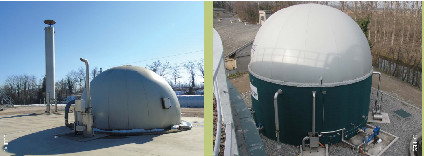
Imagen 10. Gasómetros de doble membrana, en platea de hormigón y sobre biodigestor
