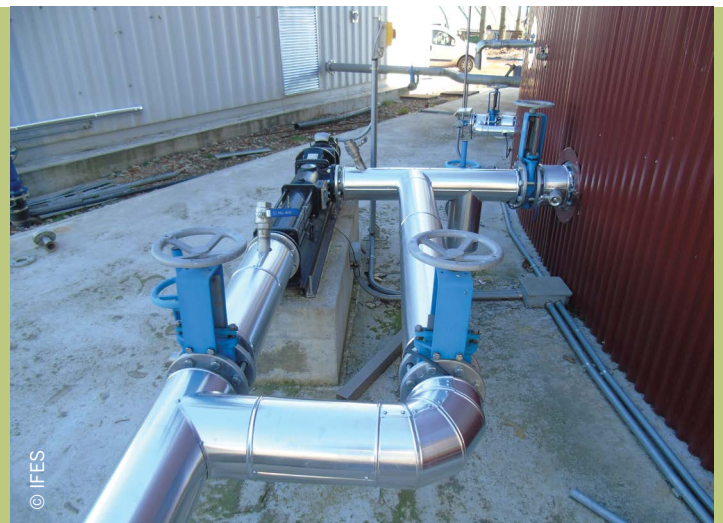
Imagen 28. Bomba de tornillo
