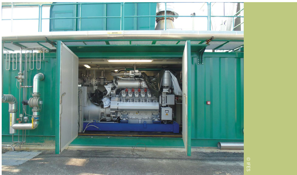
Imagen 12. Central de cogeneración de 1 MW de potencia eléctrica, con recuperación de calor de sistema de refrigeración y gases de escape
