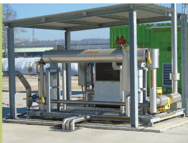
Imagen 8. Sistema chiller /enfriamiento para secado del biogás
