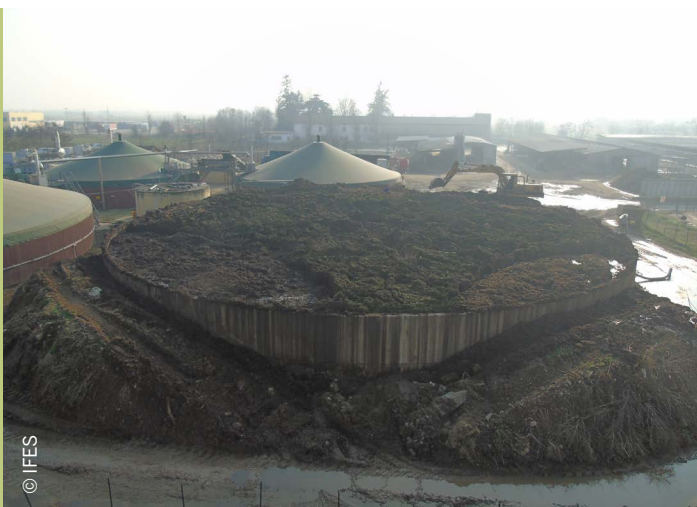
Imagen 14. Exceso de costra superficial en reservorio de digerido en central de biogás
