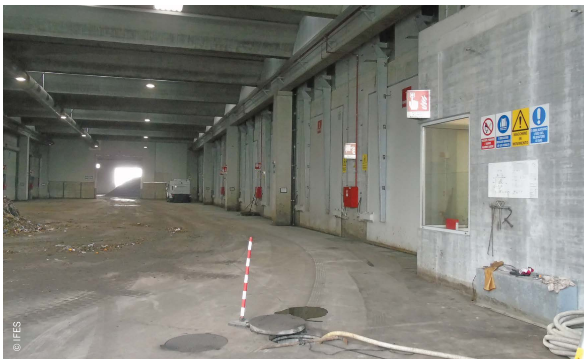
Imagen 7. Nave interna con portones de bioceldas en planta de digestión seca
