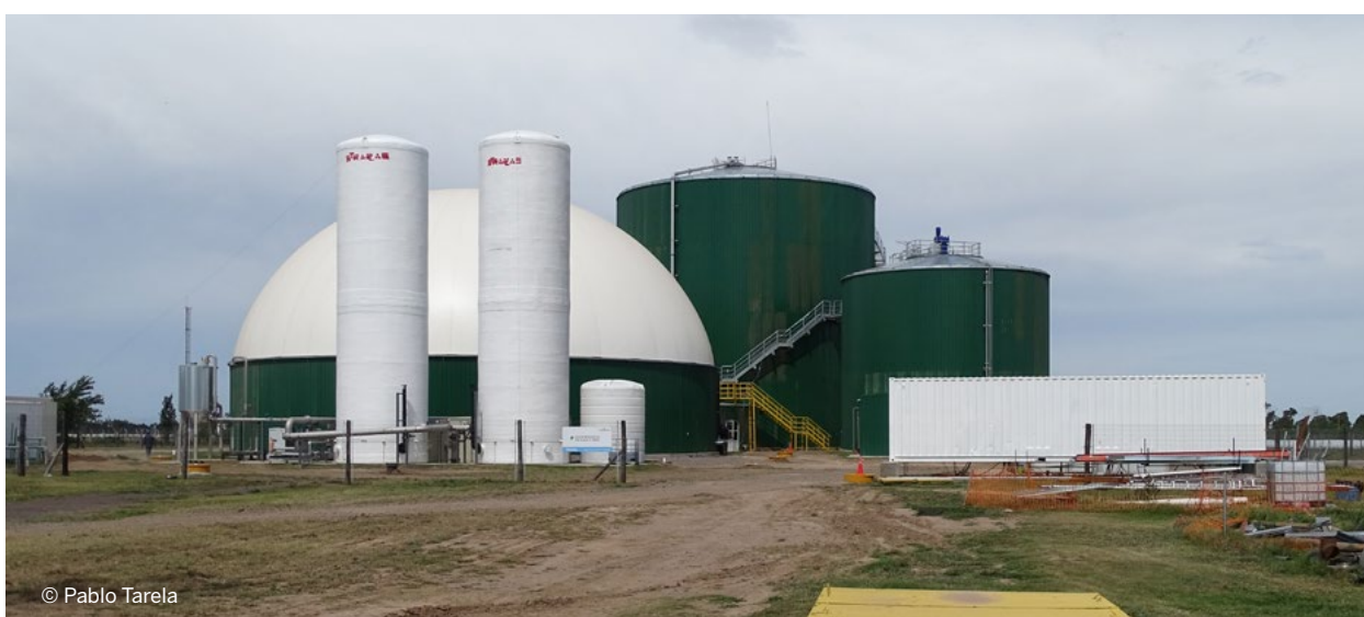
Imagen 7. Planta de biogás con silo de maíz y residuos líquidos de la producción de biocombustibles
