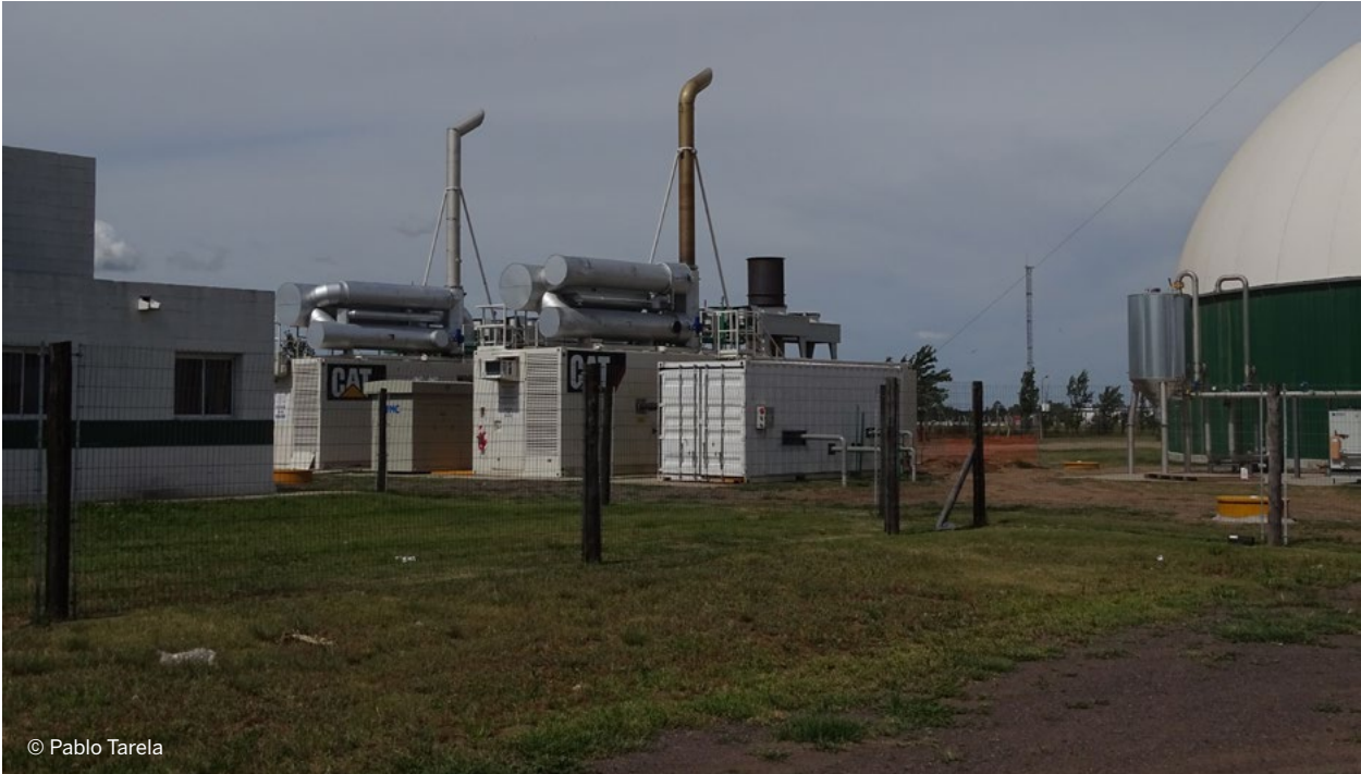
Imagen 5. Motogeneradores en disposición modular, con cabina de insonorización, en una planta de biogás
