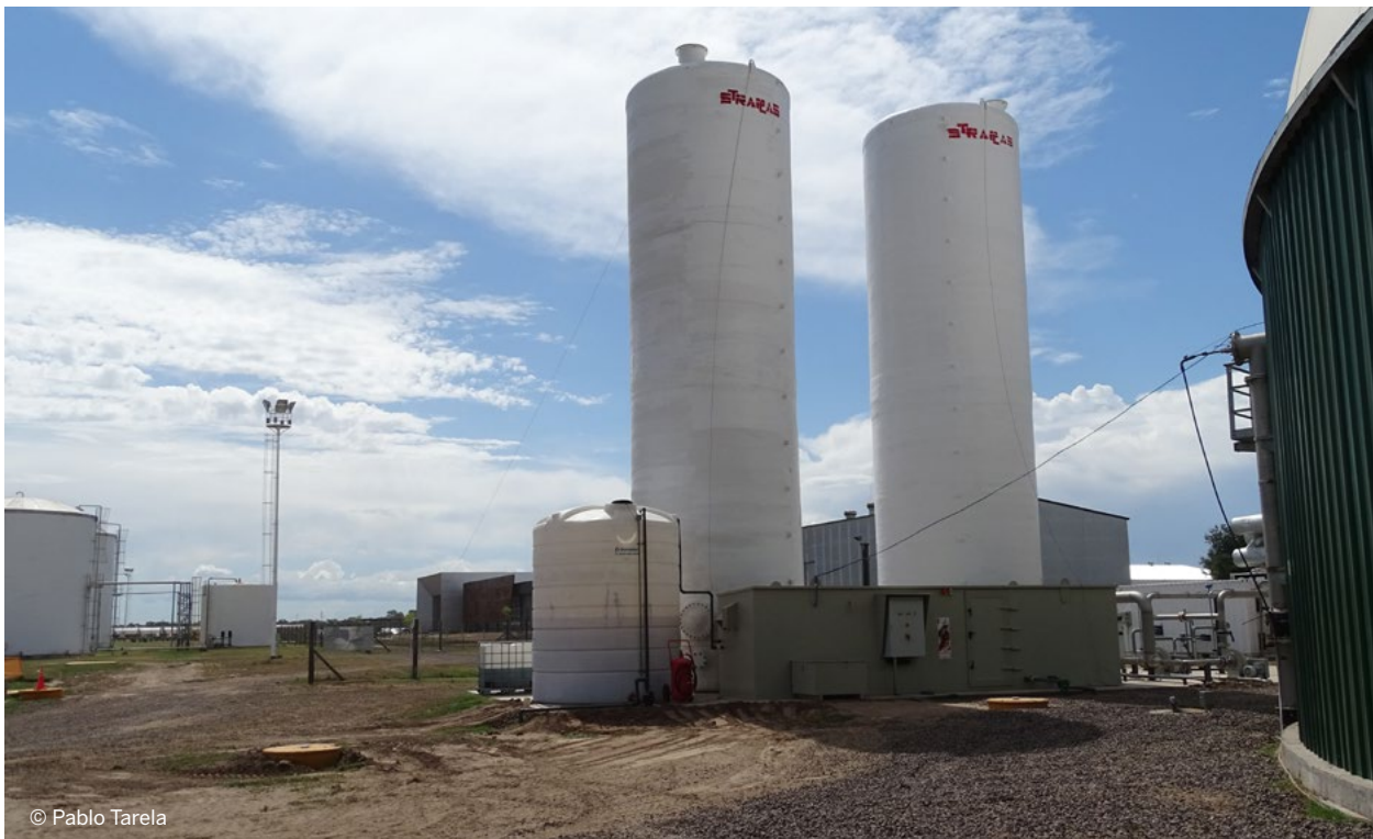
Imagen 4. Sistema de desulfuración de dos torres en una planta de biogás
